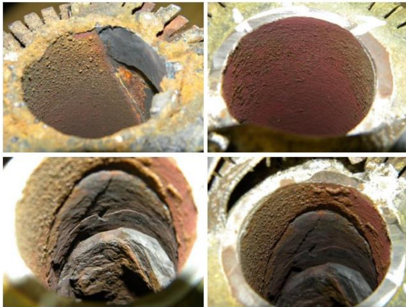
شکل (۵) لوله های اوپراتور HP قبل از تعویض لوله ها
