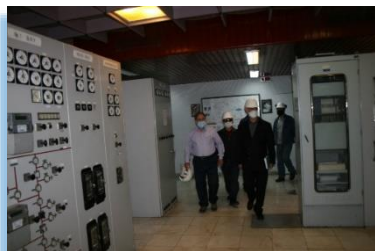
مهندس شافعی و حضور در نیروگاه سیکل ترکیبی مجموعه نیروگاهی منتظر قائم
